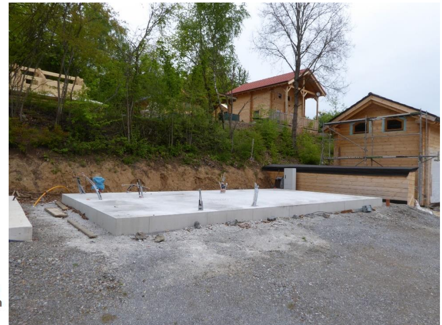
Bereich mit notwendiger Hangbefestigung
